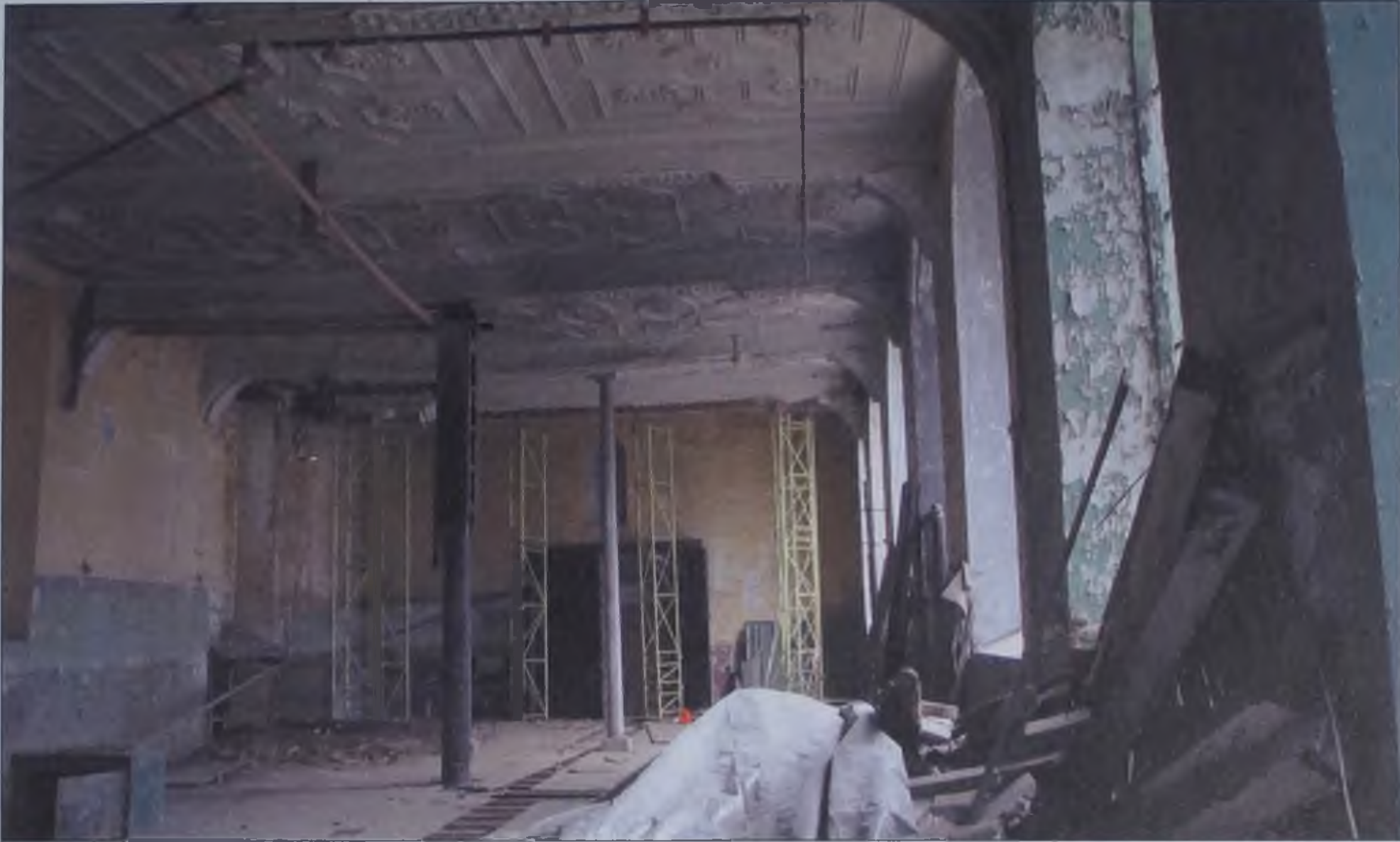
Gezicht op een deel van het te restaureren gebouw. Aanvang van de restauratie: begin 2009.
