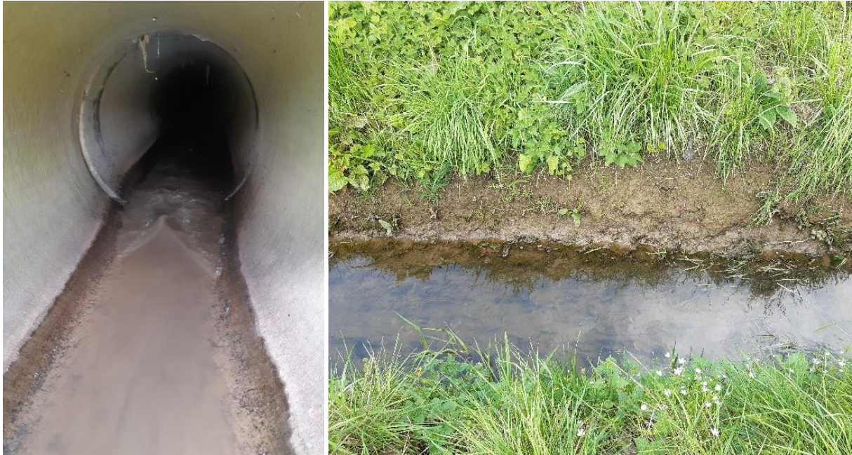
Figuur 8: Waterloop aan locatie 393 en het vismigratieknelpunt in de duiker die naar de Onkerzelestraat leidt.
