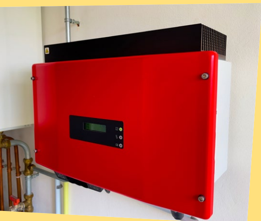
omvormerinstallatie binnen in een huis
