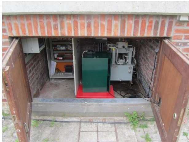
Figuur 6: ICT benodigdheden opgesteld in de afsluitbare cabine voor beheer van de stuw.
