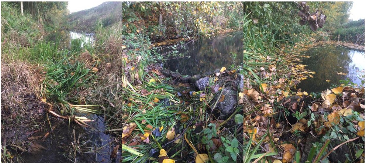
Figuur 11: Illustratie van problemen met palenrijen in de vistrap in de omgeving van de monding van de Neerschuurbeek in de Poekebeek.
