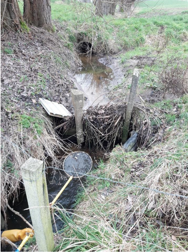
Figuur 4: Foto van de stuw stroomopwaarts Tenbergen in Brakel op de Dorenbosbeek en de duiker die niet voldoende verzonken ligt.
