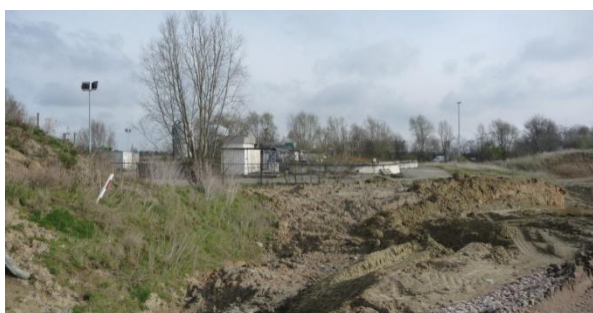
Fase VI met waterzuiveringsinstallatie ed.
