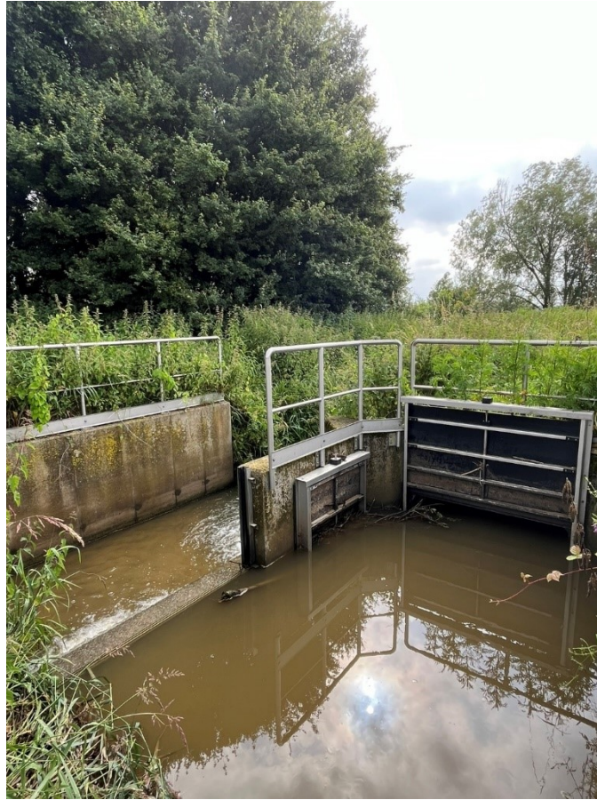
Figuur 6: De grote schuif staat open, maar door de beperkte gabariet van de Volkaartsbeek kan daar niet veel water naar toe. Het valt vooral op dat de overstort richting de Donkvijver in gebruik is. Dit is eigenlijk de overstromingsmodus van het kunstwerk.
