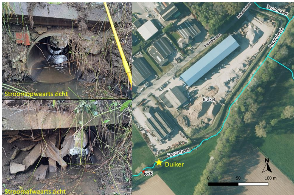
Figuur 6 - Lokalisering en foto's van een mogelijk problematische duiker op de Dorenbosbeek ter hoogte van het industrieterrein. ©Mechtild Zoeter Vanpoucke.
