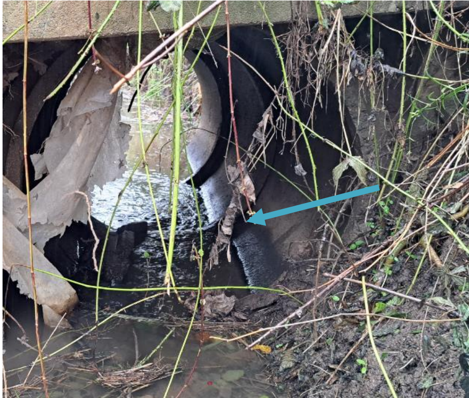
Figuur 7 – Detailopname van de duiker in Figuur 6 met aanduiding van verval ter hoogte van overgang in de duiker zelf. ©Mechtild Zoeter Vanpoucke.
