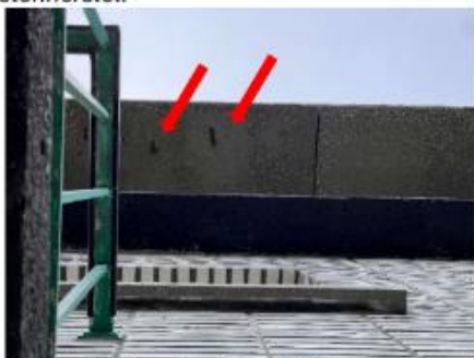
Figuur 2 - Betonrot dakrand
