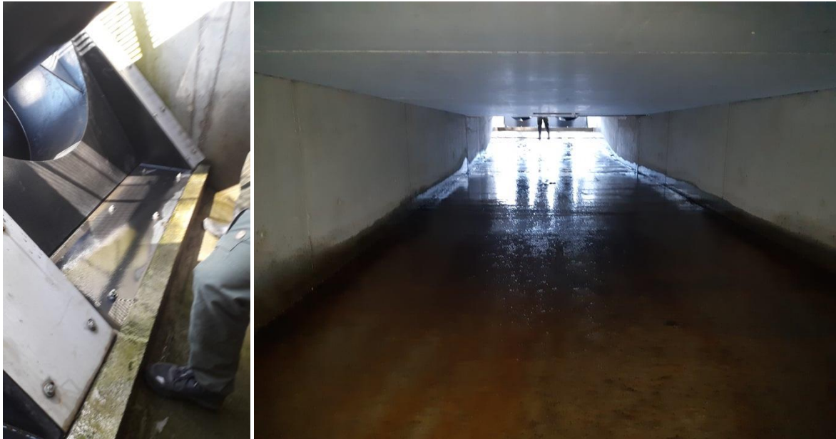
Figuur 3 – uitstroom van de vijzels (links) en betonnen koker (rechts) langs waar het water en de vissen het pompgemaal verlaten.
