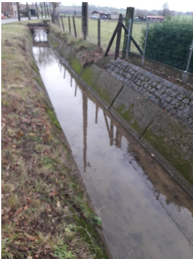
Figuur 4: Foto genomen van de Molenbeek waarbij de plaatsing in betonnen U-elementen duidelijk zichtbaar is.
