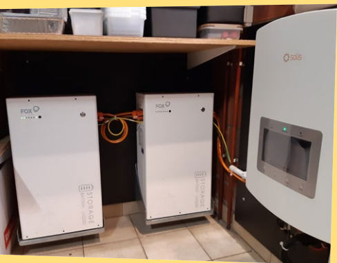
installatie thuisbatterij met omvormer
