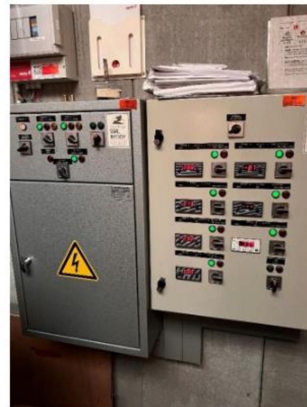
Sturing stookinstallatie (en ventilati
