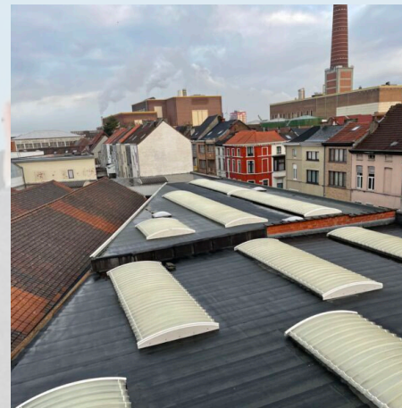
1000 panelen - Milleken Gent – Februari 2025
