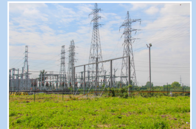
De hoogspanningspost van Elia wordt bevestigd in het PRUP (artikel 7 op het grafisch plan).
