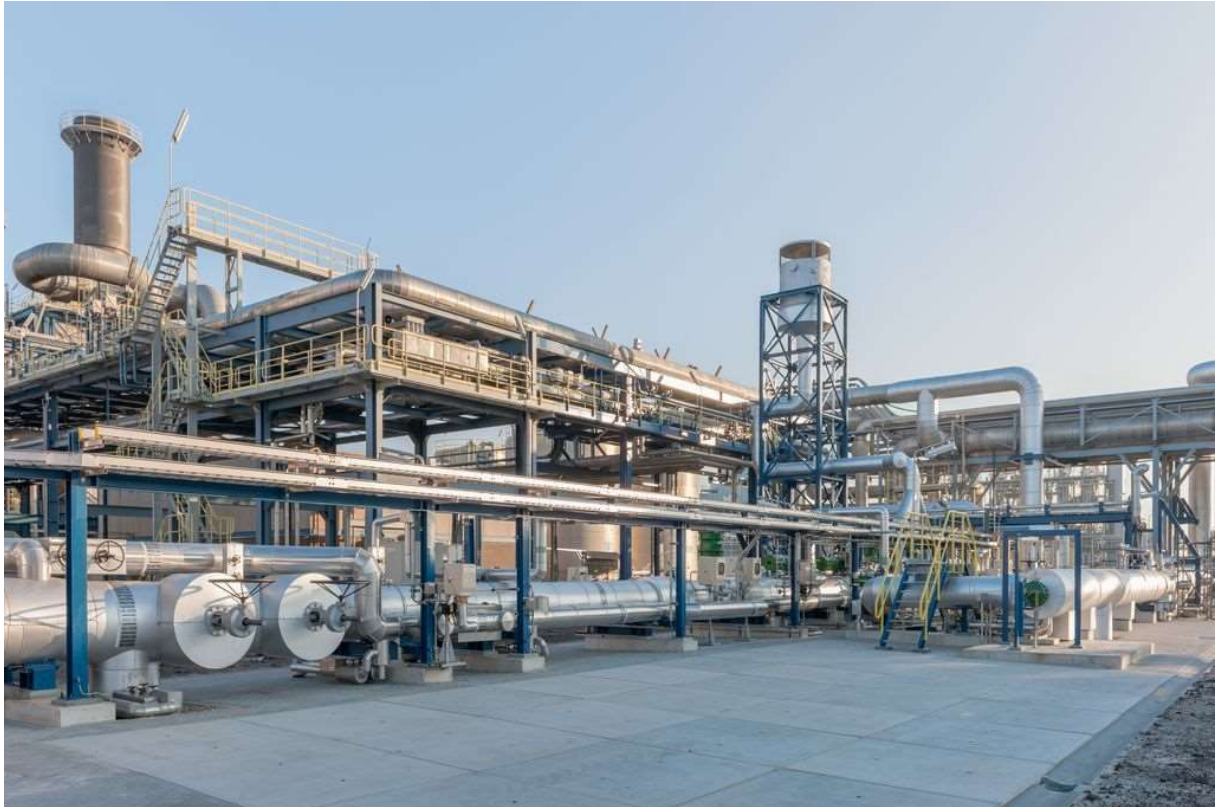
Figuur 10: Groene waterstoffabriek in Rotterdam ( https://www.portofrotterdam.com/nl/havenkrant/havenkrant-43/grootste-groene-waterstoffabriek-van-europa )
