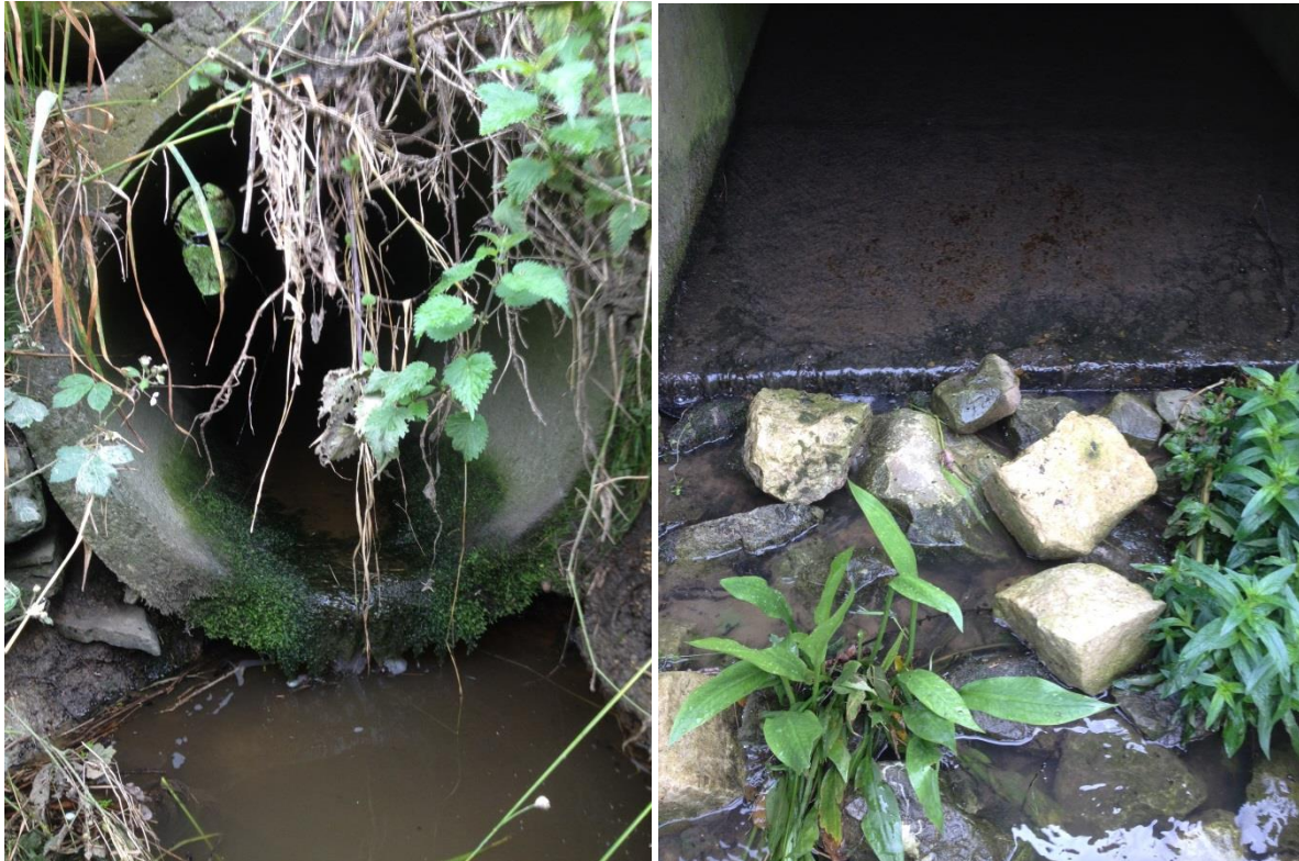
Figuur 3 – Mogelijke migratieknelpunten ter hoogte van locatie 4 (linkse foto) en locatie 5 (rechtse foto).
