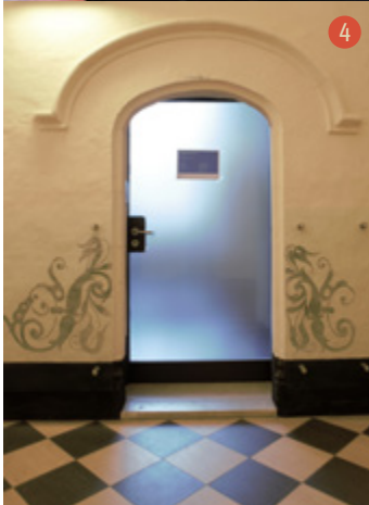
Lambrisering op de benedenverdieping van de zuidelijke vleugel van de Braunschool. Fresco's naast een celdeur.
